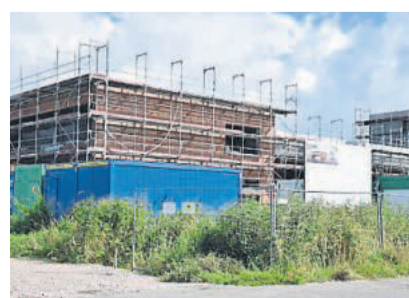
Auf der Baustelle der Feuerwache geht es voran. 8,1 Millionen Euro soll das Gebäude kosten. Foto: Res
